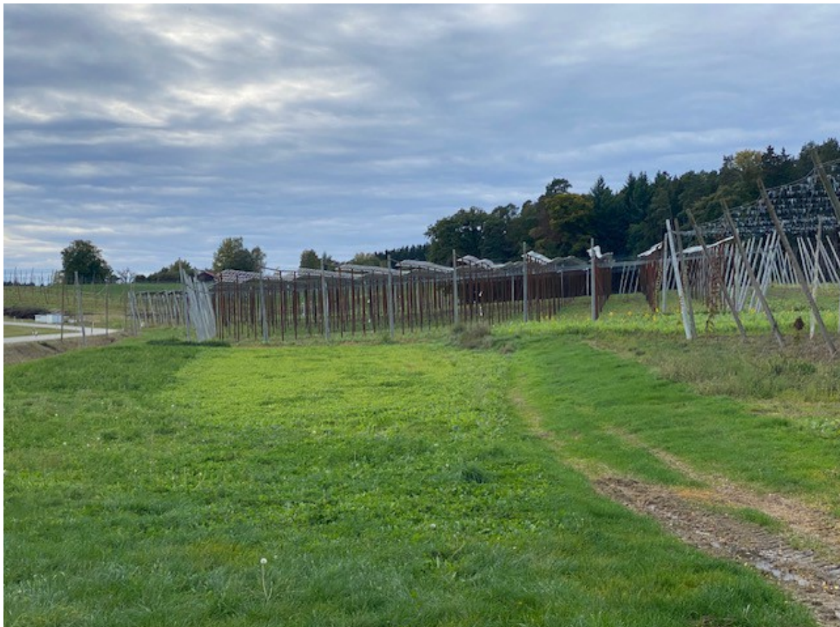
Anordnung von Modulen auf einem bestehenden Hopfengarten als Agri-PV Anlage.
